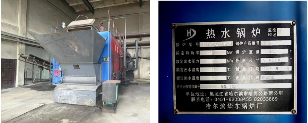
图 1 已新建锅炉铭牌及实物照片
