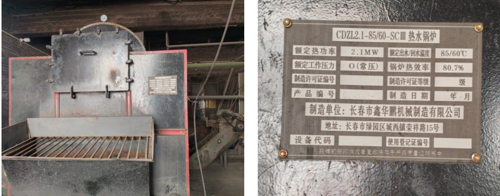
图 1 已新建锅炉铭牌及实物照片
