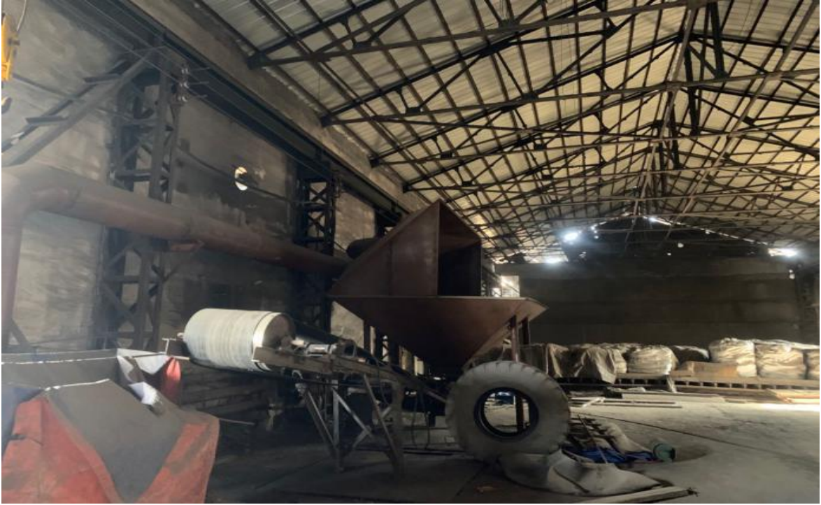
生产车间内部
